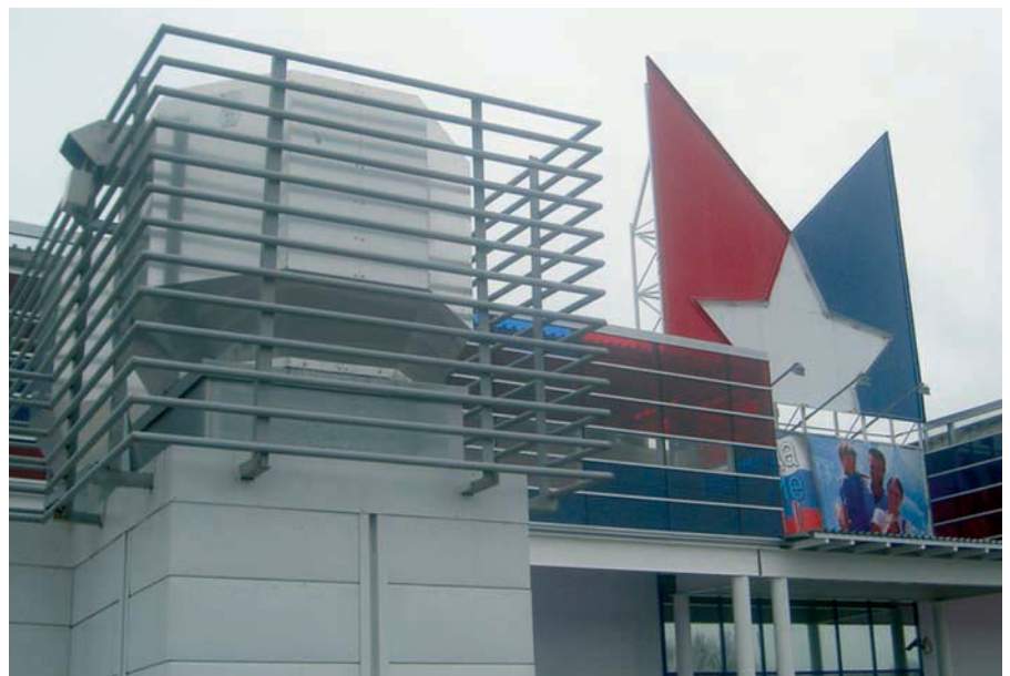
Дымоудаление из подземной автостоянки ТЦ "Мосмарт" (г.Москва, Россия)
